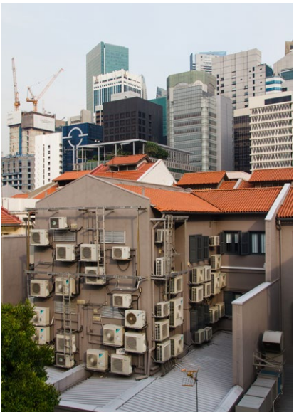
新加坡一栋住宅楼外墙上的空调设备（2013）
