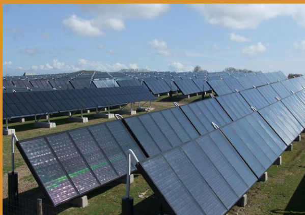
森讷堡太阳能热电厂（左）和热电联发电厂（右）
